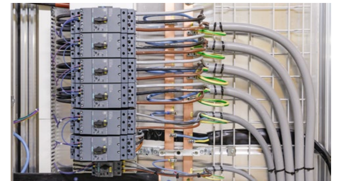
Die SF Elektro Engineering AG aus Flums übernahm das gesamte Elektroengineering für das Solarfaltdach sowie die anspruchsvolle Programmierung der S7-1500 Steuerung und des Leitsystems.
