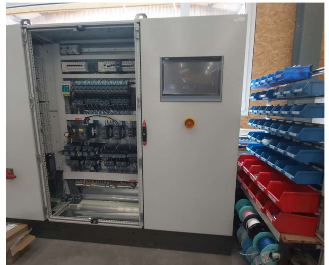
Bild: neue Hauptverteilung
