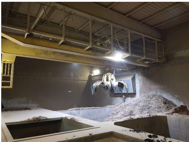
Bild: Bunkerkran und Kranführerkabine.
