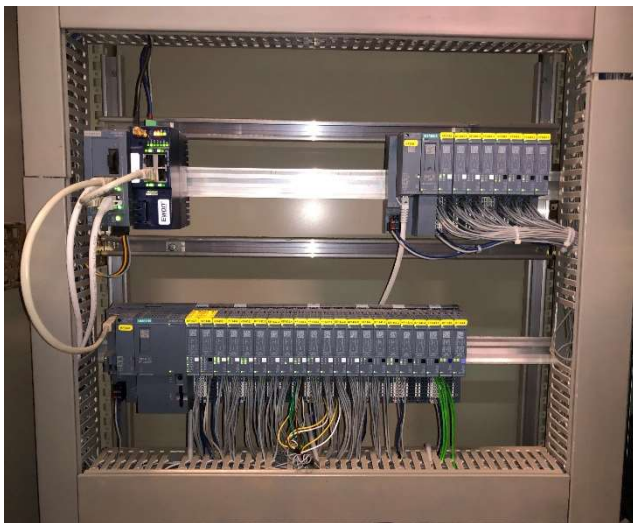
Bild: Neue S7 Steuerung
