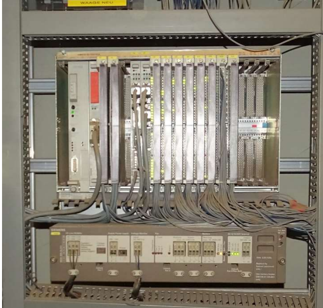
Bild: Alte S5 Steuerung
