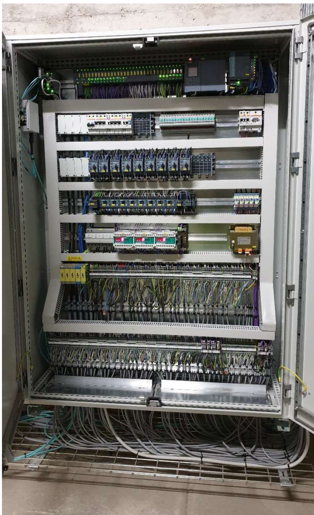
Schaltschrank mit neuesten Komponenten
