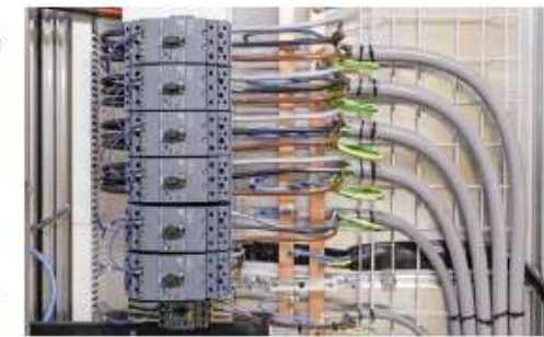
Die SF Elektro Engineering AG aus Flums übernahm das gesamte Elektroengineering für das Solarfaltdach sowie die anspruchsvolle Programmierung der S7-1500 Steuerung und des Leitsystems.
