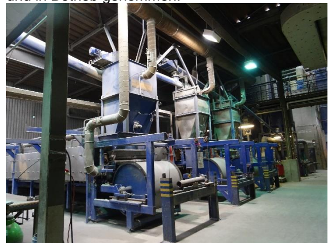
Teil der Ofenanlage
