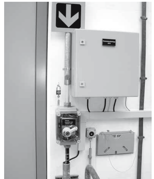
Bild 4: Anlageschalter (Kranschalter), der in der ausgeschalteten Stellung mit einem Vorhängeschloss gegen Einschalten gesichert werden kann.
